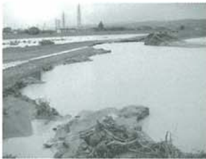
▲五十嵐川左岸破堤箇所 下流側から破堤箇所を写す。
