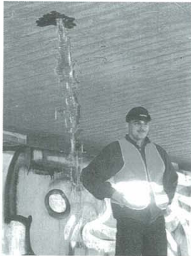
写真-1 ミュンヘンのアルベルト・シュバイツァ橋 削孔による中空型枠から漏れている水(2時間以上)
