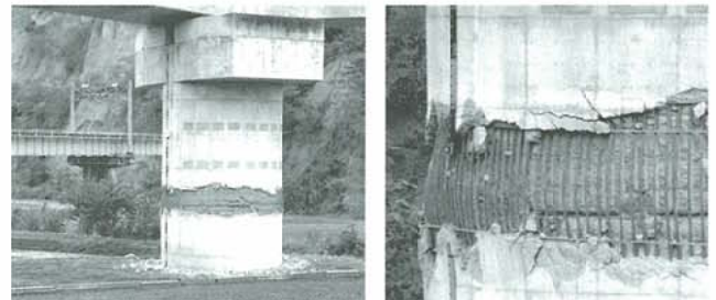
▲JR上越新幹線 川口地区 橋脚被害状況
