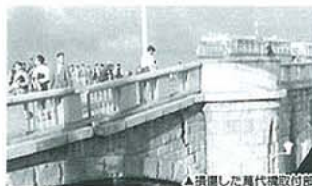
▲写真-3 取付け部の損傷
