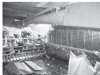
▲写真-3 橋脚柱頭部をはつり終わった空間(右側の白い壁は橋脚外側鉄板)
