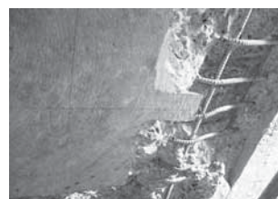
▲写真-4 上沓切断状況と既設鉄筋
