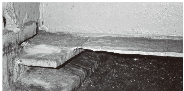
写真-1 鋼桁下フランジに発生した疲労亀裂
