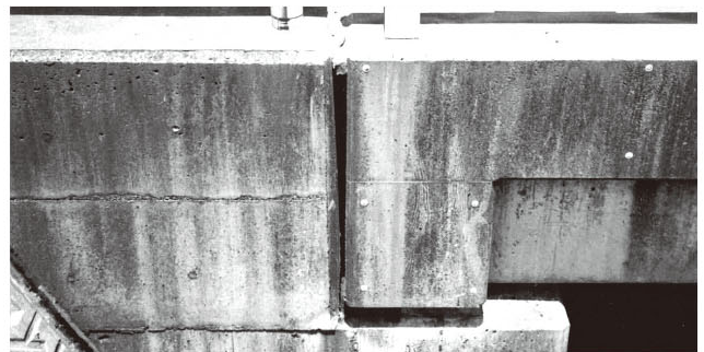
写真-5 橋台上の桁端部の異常遊間
