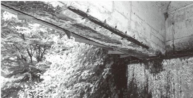
写真-3 RC桁に発生したかぶりコンクリートのはく落
