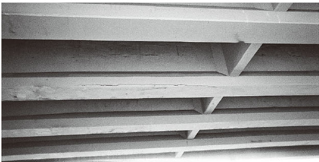
写真-2 PC桁に発生した橋軸方向のひび割れ
