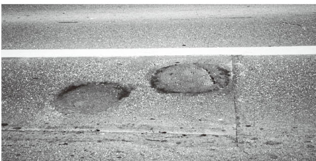
写真-4 橋面舗装上に発生したポットホール
