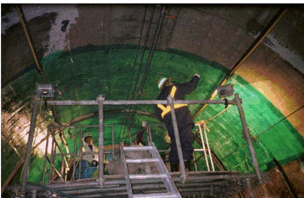
■ トンネル覆工はく落対策
