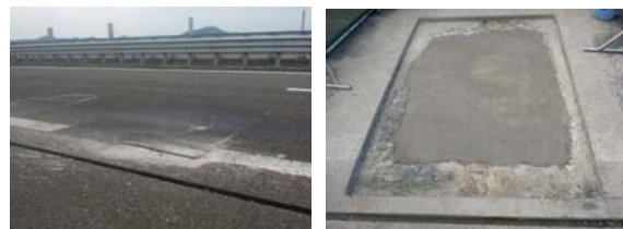
写真-2 舗装面の損傷状況 およびRC床版の補修状況
