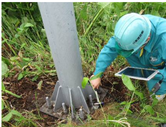
BTS 測定状況
